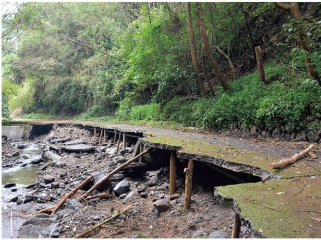
崩落した梅ヶ谷地区の農道
